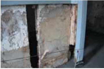
Schäden im Haus
