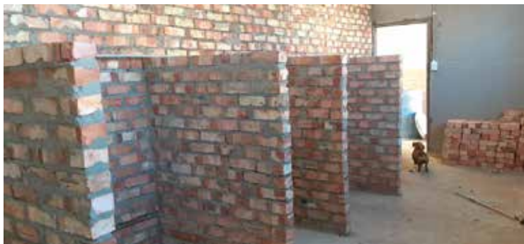
Der Bau der Toiletten musste vorläufig eingestellt werden.
